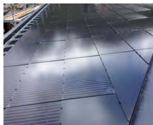
Teil der PV-Anlage auf dem Dach
